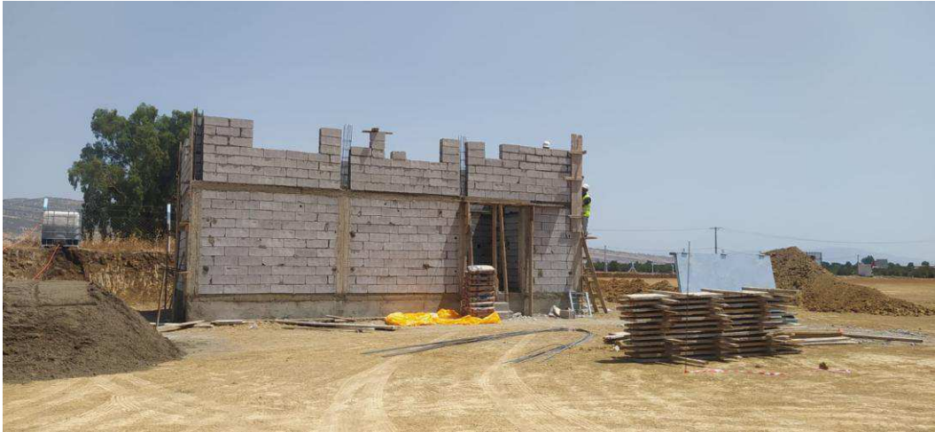
Local poste pour alimentation provisoire
